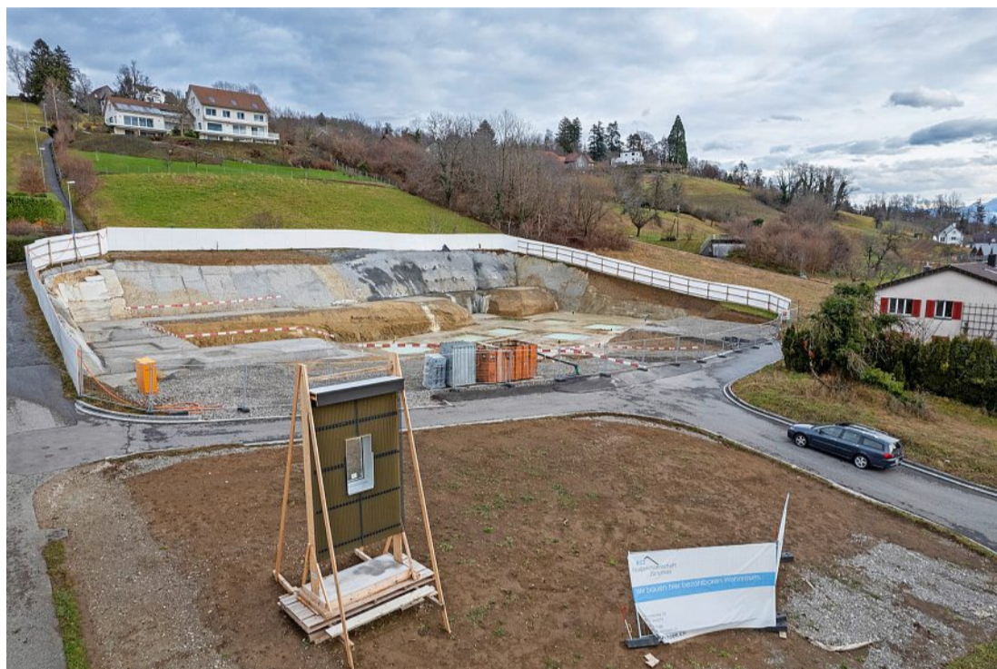
Auf der Baustelle an der Allenbergstrasse zwischen Hänsweg und Chäsrain wird in den nächsten Tagen die Arbeit wieder aufgenommen. Foto: Patrick Gutenberg
